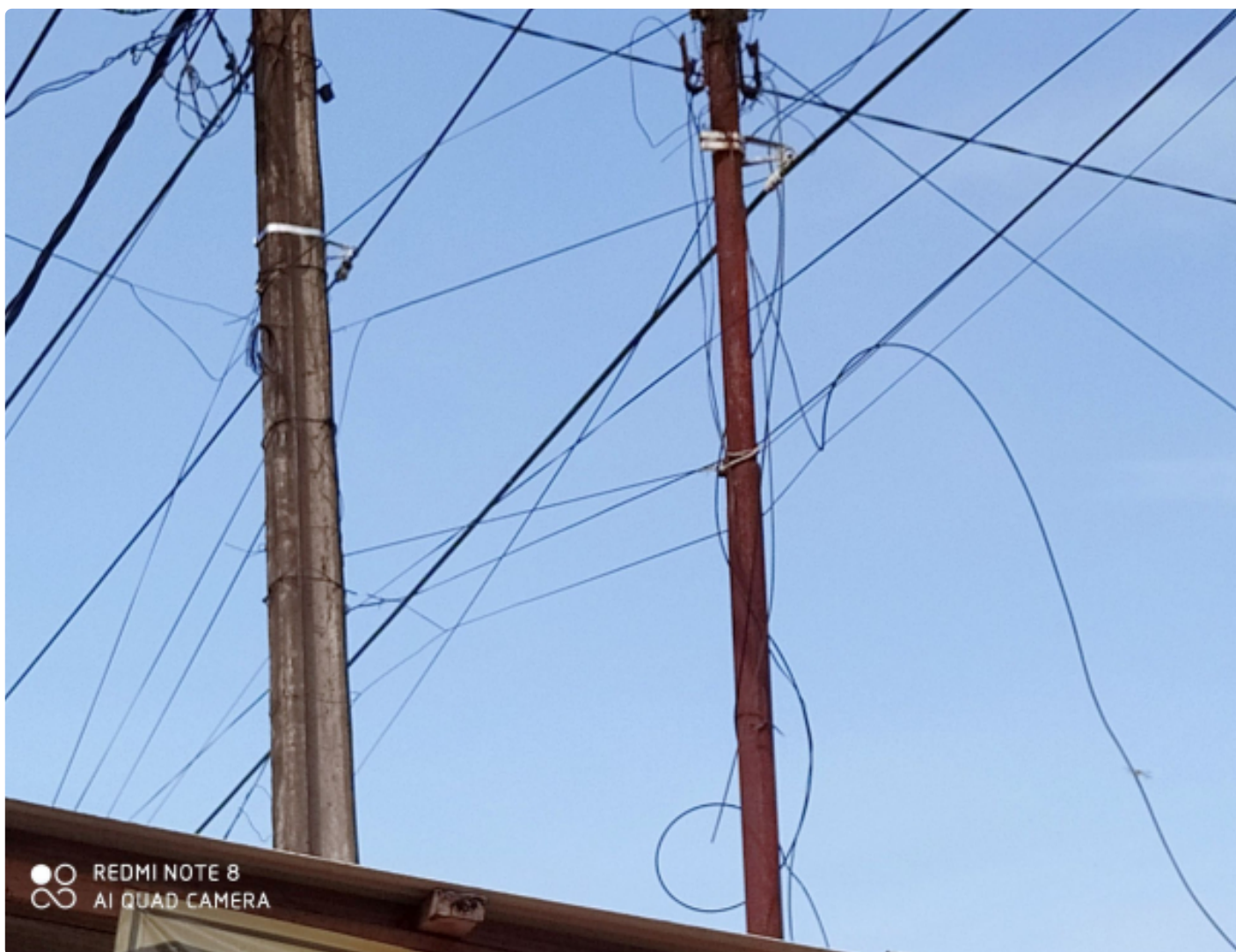
Nampak kabel semrawut di tiang Telkom dan PLN
