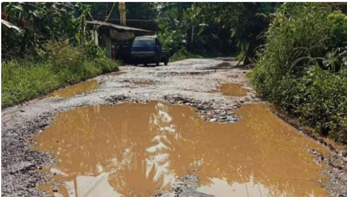
Jalan Jembatan Kayu - Wanasalam rusak parah dan lama dibiarkan
